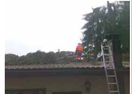
Der Orkan richtete schlimme Schäden an. Dächer und Verkehrswege mussten freigemacht werden
