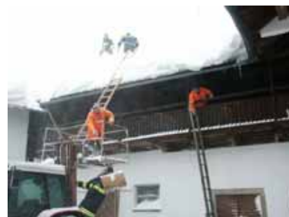
Steile Dächer bei Landw. Objekten erschweren die Arbeiten
